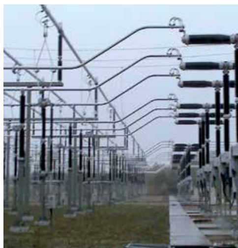
Stacja 400/110 kV Trębaczew
