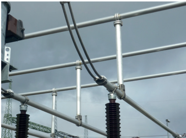
Fot. 3. Połączenie kątowe przewodów rurowych w mostach – stacja Słupsk Wierzbiecin – ENERGA Operator Słupsk.
