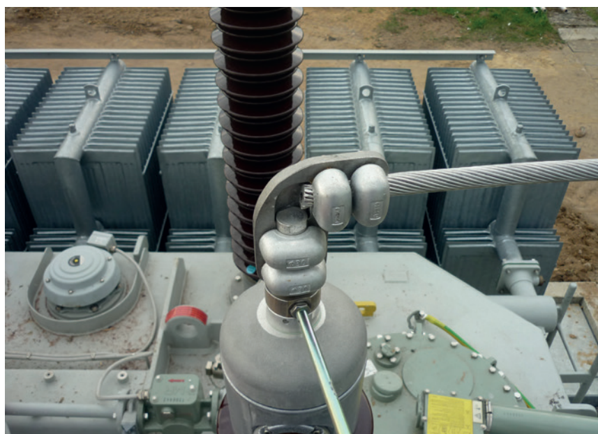
Fot. 7. Zacisk skręcany na sworzniu transformatora – stacja GPZ Drezdenko – ENEA Operator Gorzów Wlkp.
