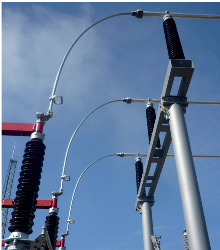
Fot. 10. Połączenie mostu z odłącznikami – stacja GPZ Międzychód – ENEA Operator Gorzów Wlkp.
