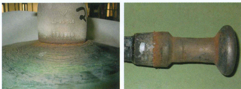
Izolator szklany, nr ref. F16P, po 25 latach eksploatacji przy napięciu 600kV DC in Itaipu Brazil. (drugi rysunek przedstawia skuteczność ochronną złączki cynkowej montowanej na trzpieniu)
