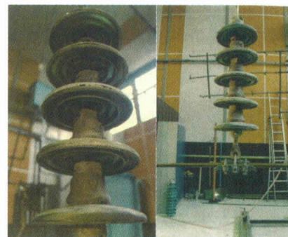
Zdj. 5: Elektryczne badania typu izolatorów BS1513 po 27 latach pracy na linii 132 kV w Malezji.
