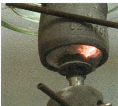
Zdj. 4: Łuk elektryczny pozostający na zewnętrznej warstwie elementu potłuczonego izolatora szklanego
