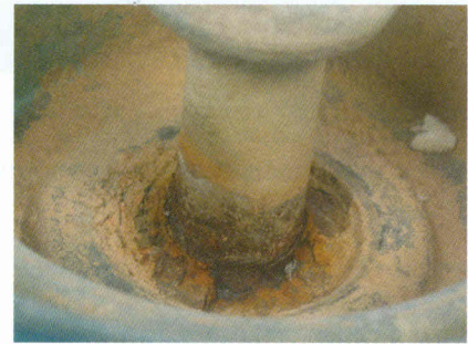
Zdj. 2: Korozja szyjki trzpienia po ponad 20 latach pracy w ciężkich warunkach (Iran)
