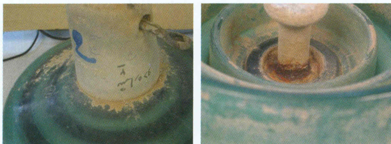
Izolator szklany, nr ref. U300, po 30 latach eksploatacji w Iranie
