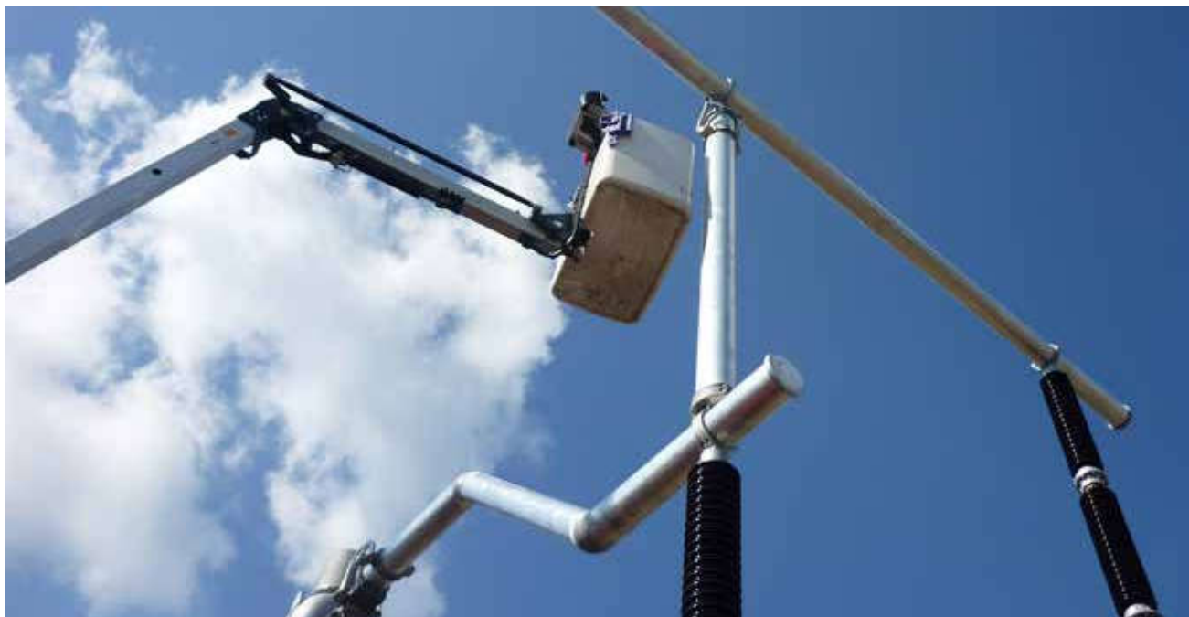
Fot.2 Montaż połączenia pionowego z zaciskami kompensacyjnymi rurą \varnothing 250 do 4000A na stacji Bydgoszcz Zachód.
