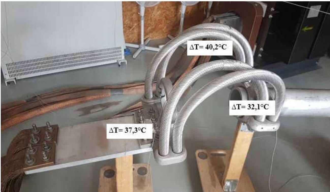
Fot.3. Pomiar przyrostu temperatury \Delta T na elementach zacisku z poczwórnymi przewodami w mostkach prądowych LORÜNSER przy przepływie prądu 4000 A w stosunku do temperatury otoczenia t = 24,4^{\circ}\text{C}
